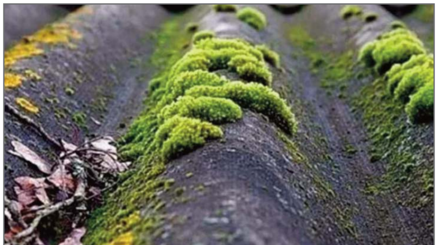
Рис. 5. Повреждение шифера лишайниками [13]
