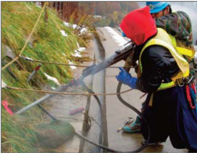
Рис. 9. Использование ручного пневматического перфоратора для бурения с помощью буроинъекционных штанг малых типоразмеров (с внутренними/наружными диаметрами от 30/16 до 40/16) [8]
