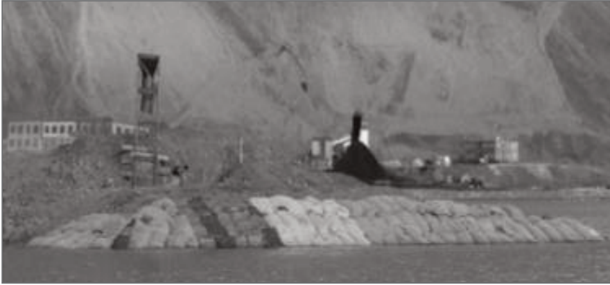
Рис. 8. Использование геомешков для уменьшения береговой эрозии было протестировано в месте расположения шахты «Свеагрува» («Свеа») на Шпицбергене [31]
