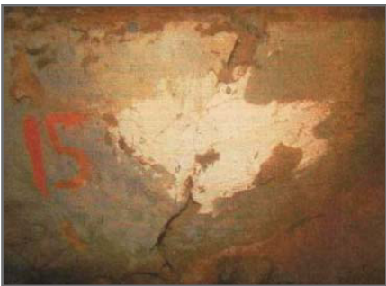
Рис. 4. Место в зоне потолочного шва, откуда отвалился большой кусок штукатурки
