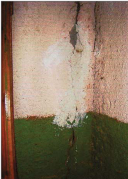
Рис. 3. Трещины в стене и на стыках панелей, проявившиеся сквозь штукатурку и краску
