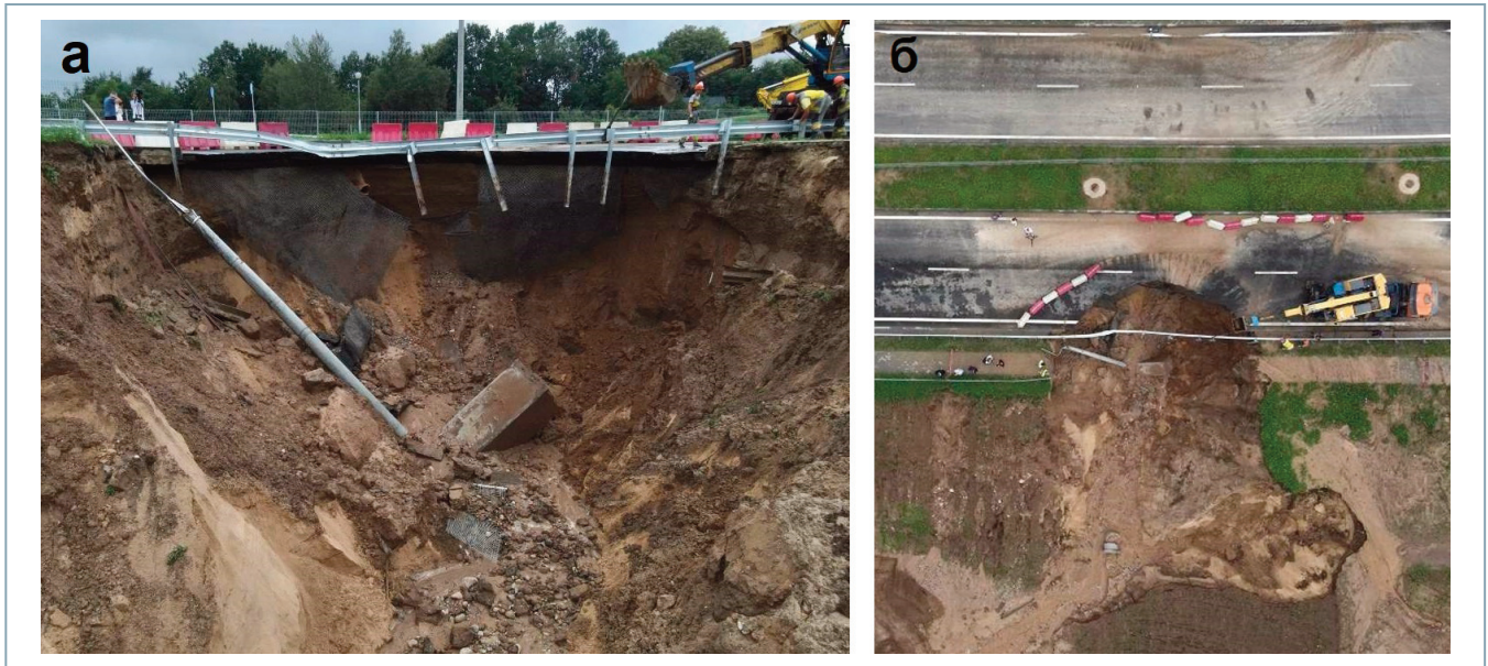
Рис. 8. Оползень на новой объездной дороге г. Гродно, произошедший 04.07.2021: а – вид сбоку; б – вид сверху [29]
