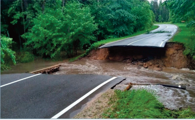
Рис. 7. Часть автомобильной дороги Р54 в Воложинском районе Минской области, которая была разрушена 30.05.2019 в результате водной эрозии из-за сильного ливня [28]
